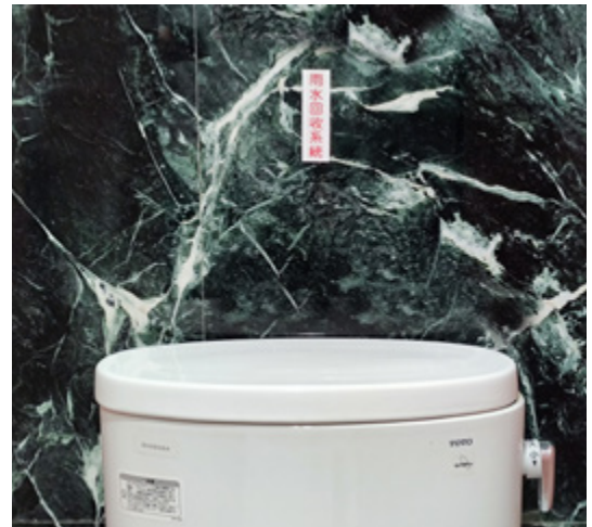
本行總部大樓設有雨水回收系統，所儲存之雨水用於馬桶或大樓清潔用水使用
